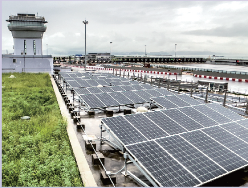
港珠澳大橋消防局暨救護站在天台裝置太陽能板，提供環保的電力能源。
